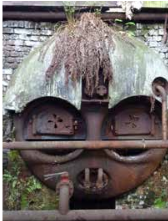
Fig. 146 Une des quatre chaudières Piedbœuf.
