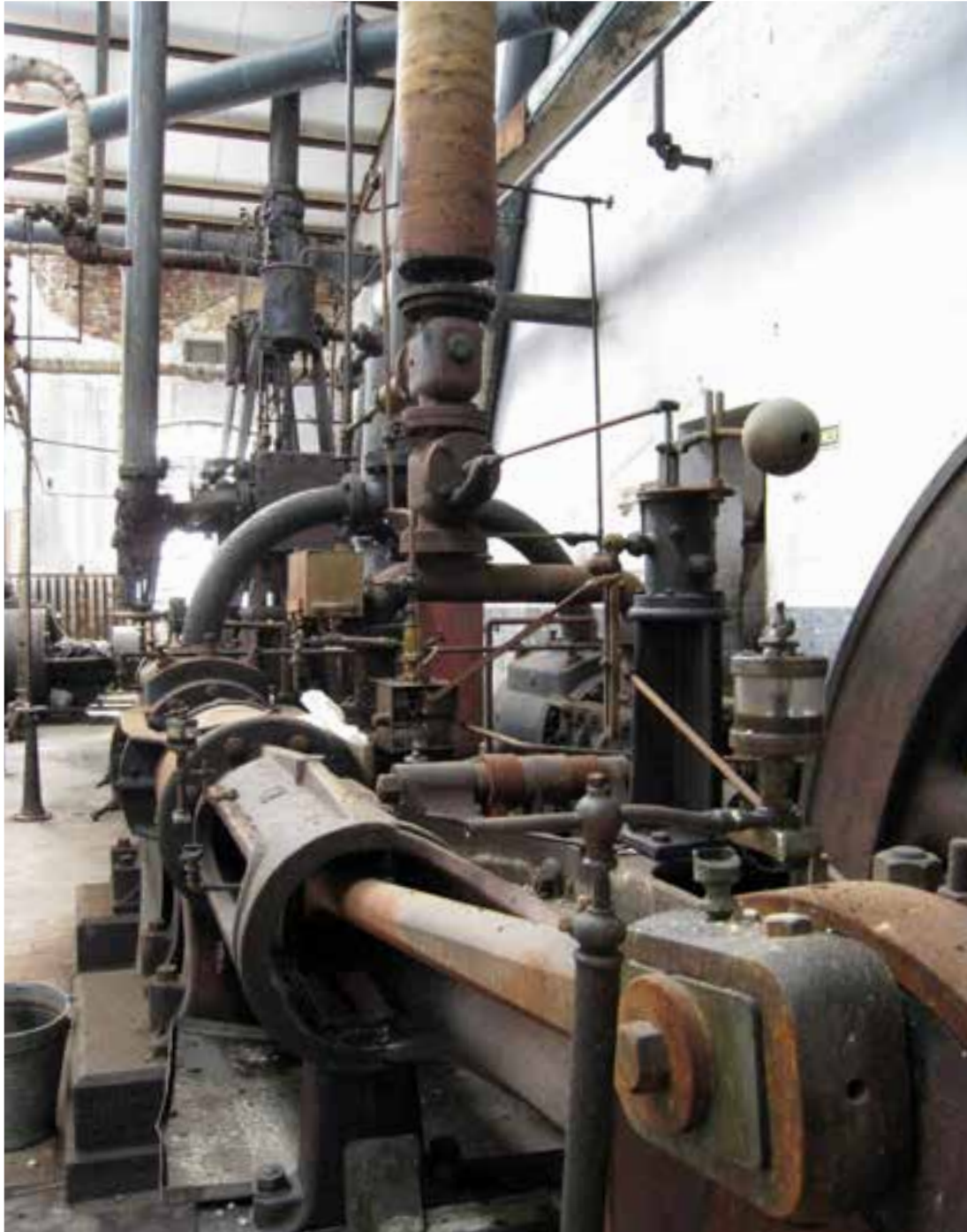
Fig. 153 Détail d'un des compresseurs.
